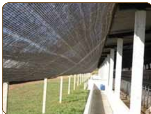
Figura 12: Sombrite para reduzir a incidência de sol no interior das instalações.
